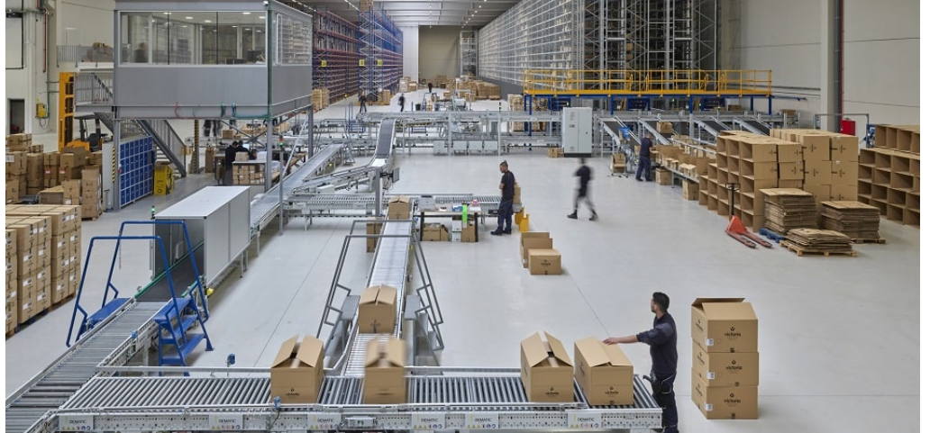
Imagen del nuevo almacén de Victoria, que cuenta con un sistema automatizado.
